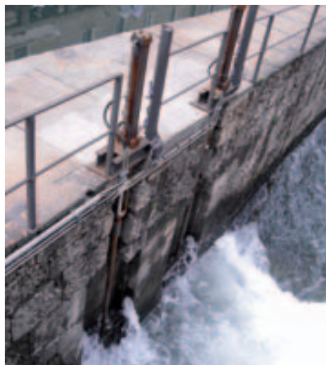
Impianto mini idroelettrico, Comune di Milano
