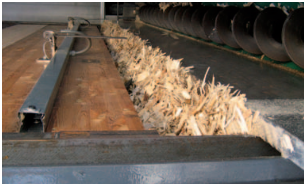
Impianto per lo sminuzzamento della biomassa solida
